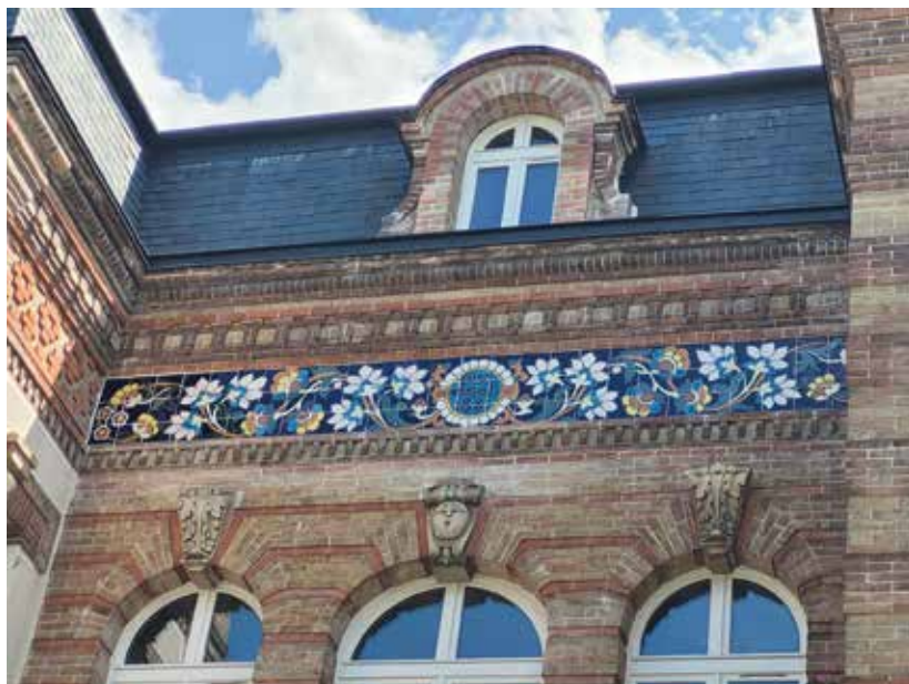
Après six mois de restauration, la mosaïque de près de 6 mètres de long et aux élégants motifs de roses sur fond bleu outre-mer a retrouvé toute sa majesté !
