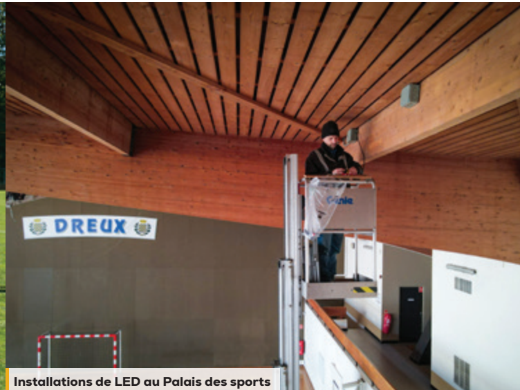
Installations de LED au Palais des sports
