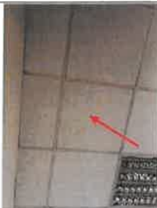
Photo n° PhA007 Localisation : Douche Ouvrage : 4 - Plafonds et faux plafonds - Faux plafonds Partie d'ouvrage : Panneaux et plaques Description : Panneaux et plaques
