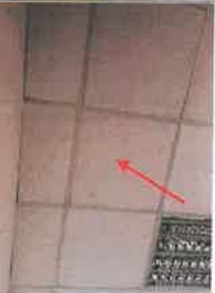
Photo n° PhA013 Localisation : Palier Ouvrage : 4 - Plafonds et faux plafonds - Faux plafonds Partie d'ouvrage : Panneaux et plaques Description : Panneaux et plaques
