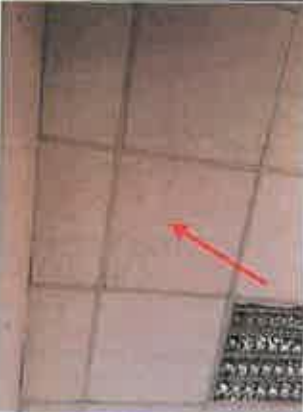
Photo n° PhA012 Localisation : Local Ouvrage : 4 - Plafonds et faux plafonds - Faux plafonds Partie d'ouvrage : Panneaux et plaques Description : Panneaux et plaques
