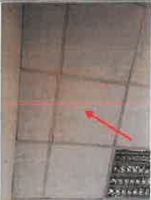
Photo n° PhA008 Localisation : Reunion Ouvrage : 4 - Plafonds et faux plafonds - Faux plafonds Partie d'ouvrage : Panneaux et plaques Description : Panneaux et plaques
